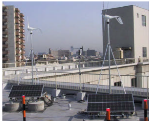
工学部7号館屋上にある風力・太陽光発電機
