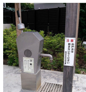
写真 手押し式災害用井戸 （東京都国分寺市）
