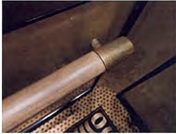
(12月29日 19:03) 消毒薬で度重なる拭き掃除が行われ塗装がはげたエレベーター内の手すり。金属部分も少し変色。
